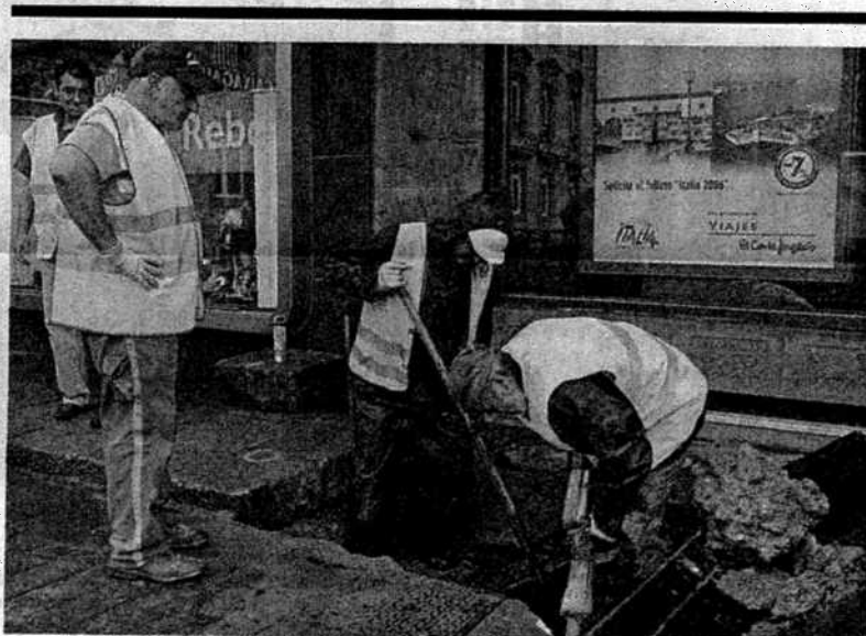
Los vecinos de la calle de la Iglesia estuvieron gran parte del día sin agua como consecuencia de la avería.
